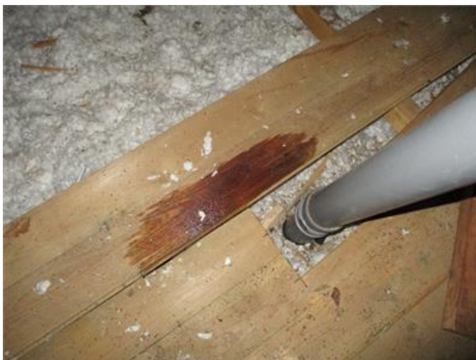
Fuktfleck på golvet i vind efter läckage från avloppsluftare
