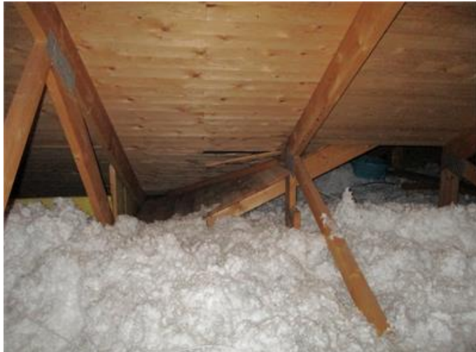
Missfärgningar på takbotten i rännal och bräda har släppt från taket
