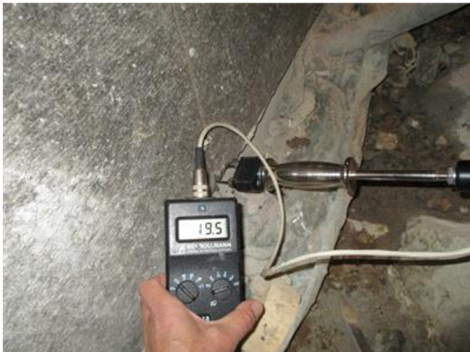
Fuktmätning i väggsyll i vägg mellan pentry och krypgrund
