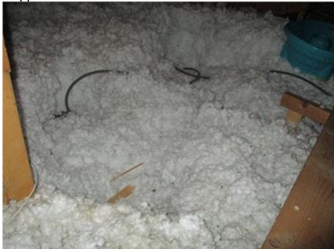
Isoleringen i vindsbjälklaget är borttagen på flera ställen
