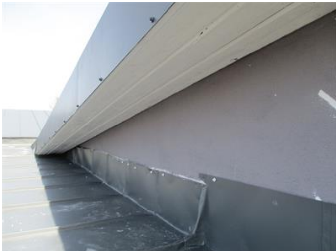
Takplåt bristfälligt infäst i fasad
