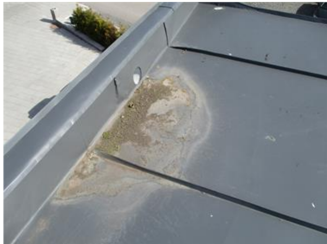
Exempel på lågpunkt i takplåt
